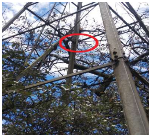
Foto No. 4. Sistema de extracción desconectado
