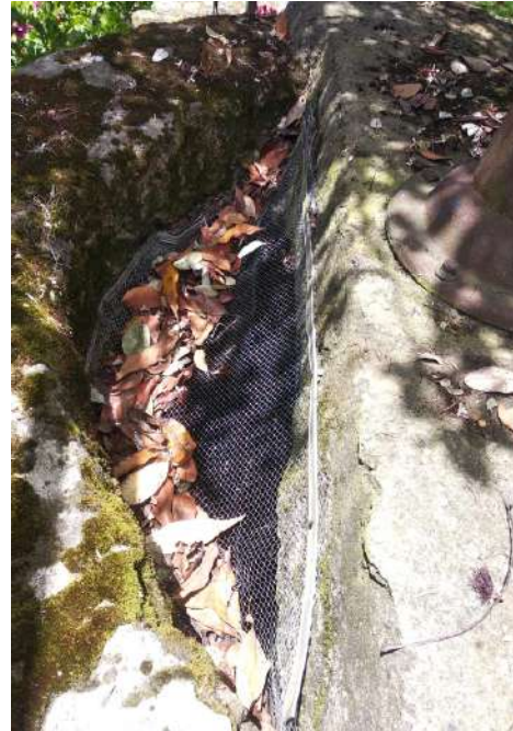
Foto No. 6. Malla de protección
