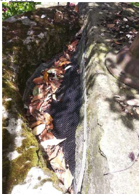
Foto No. 6. Malla de protección
